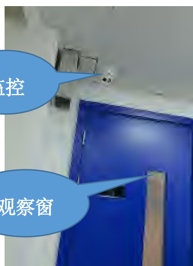
仓库出入口监控及观察窗
